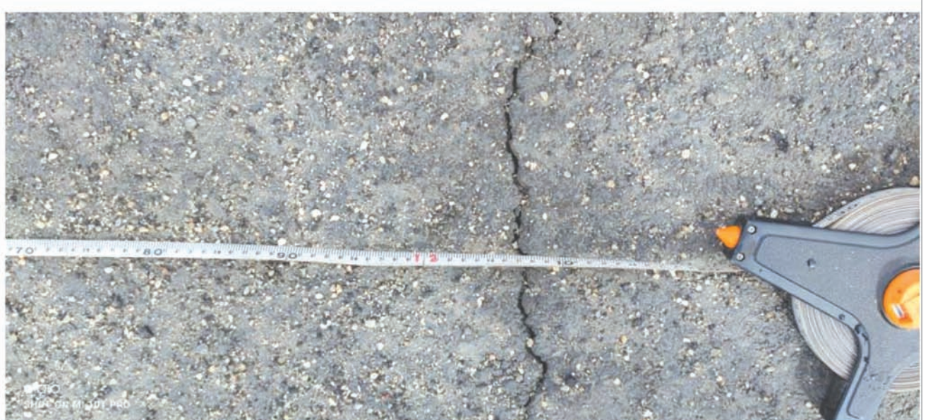
Фото №25. Трещины в асфальте.
