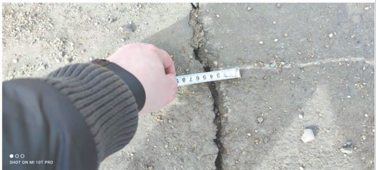
Фото №26. Трещины в асфальте.
